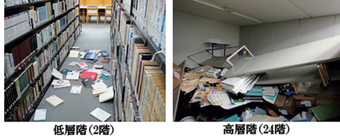
図11 東京都内の同一ビルにおける低層階と高層階の被害状況
